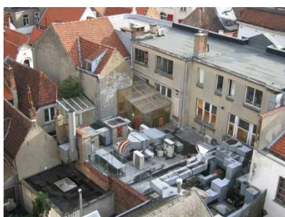
Technische installaties binnen in blok 5 en 6
